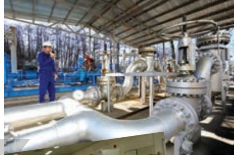
منطقه شمال، ایستگاه فشارشکن لاجیم
