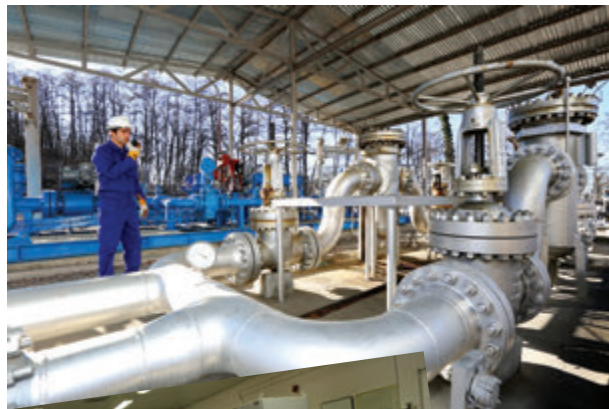
منطقه شمال - ایستگاه فشارشکن لاجیم
